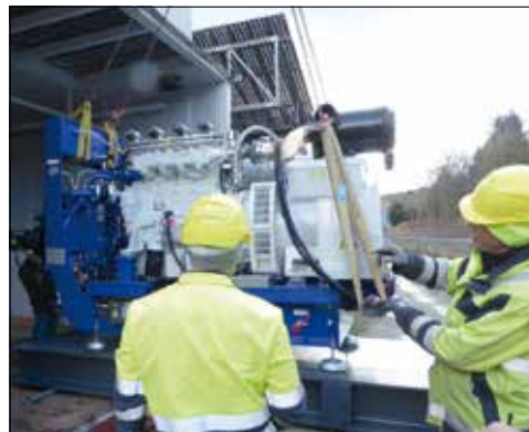
Das neue Blockheizkraftwerk Foto: Stadtwerke Oelsnitz/V. GmbH)
